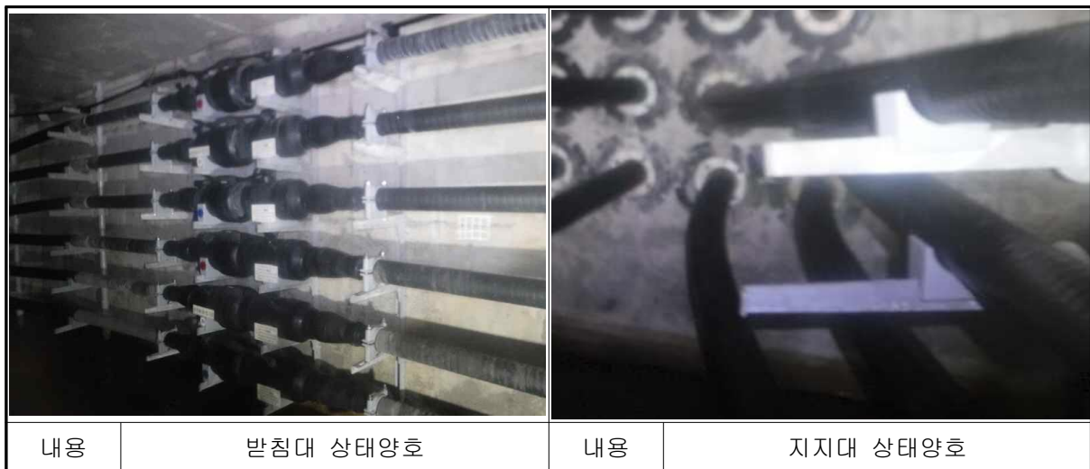
【사진 13.24】 부속 및 부대설비 현황
