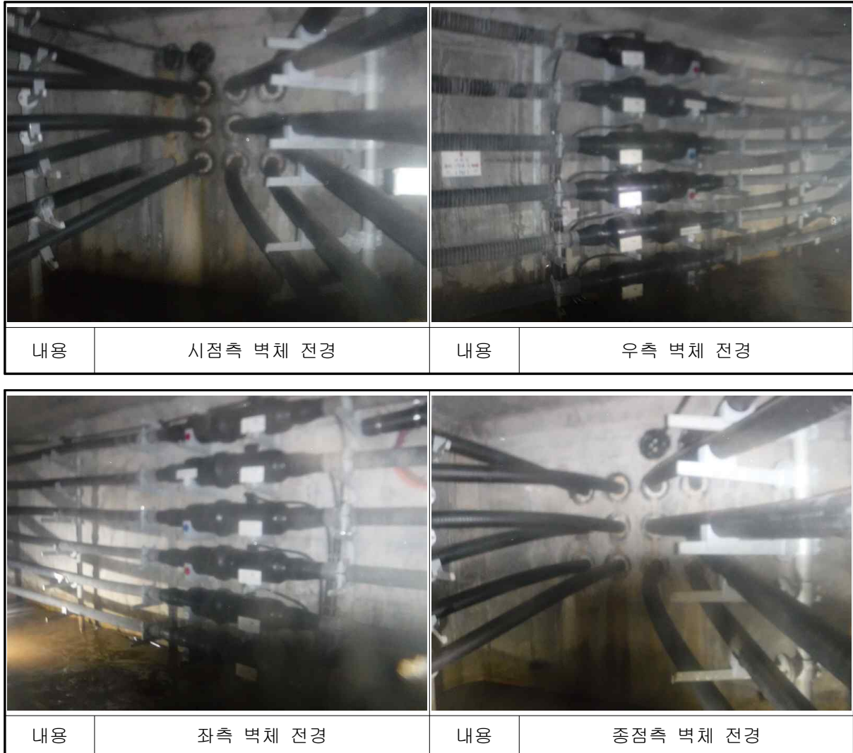
[사진 13.17] 신파주문발#9 전경
