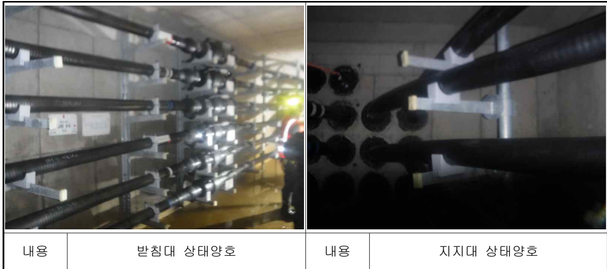
【사진 13.4】 부속 및 부대설비 현황
