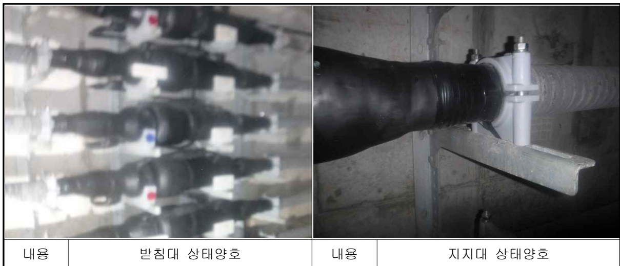
【사진 13.28】 부속 및 부대설비 현황
