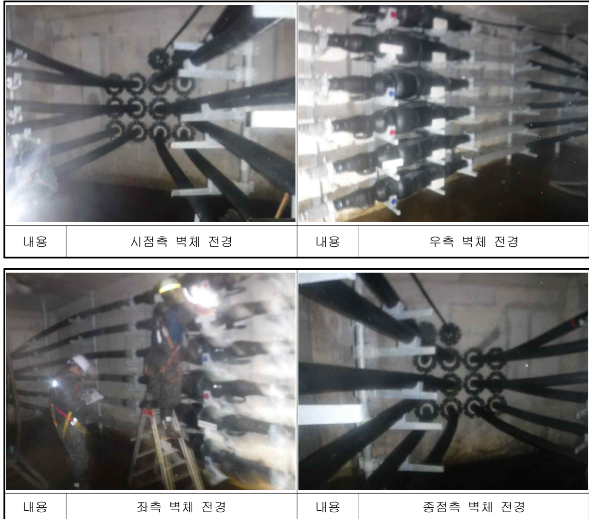
[사진 13.25] 신파주문발#11 전경
