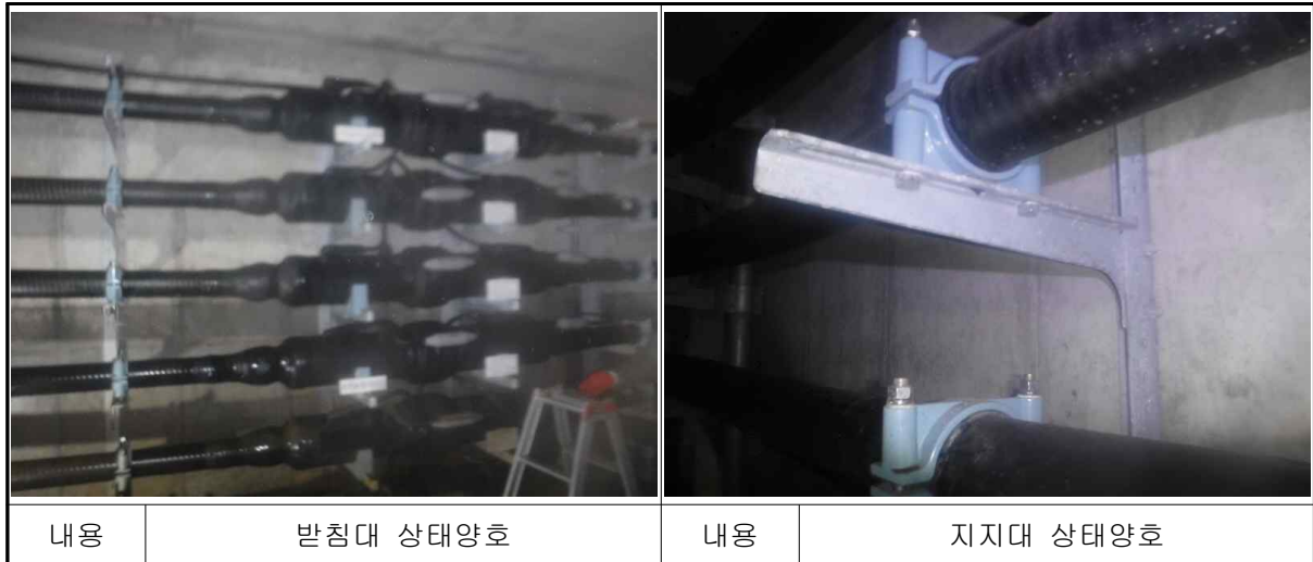
【사진 13.12】 부속 및 부대설비 현황
