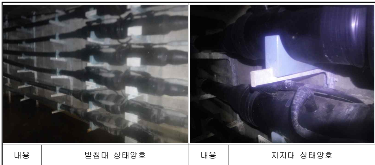
【사진 13.16】 부속 및 부대설비 현황
