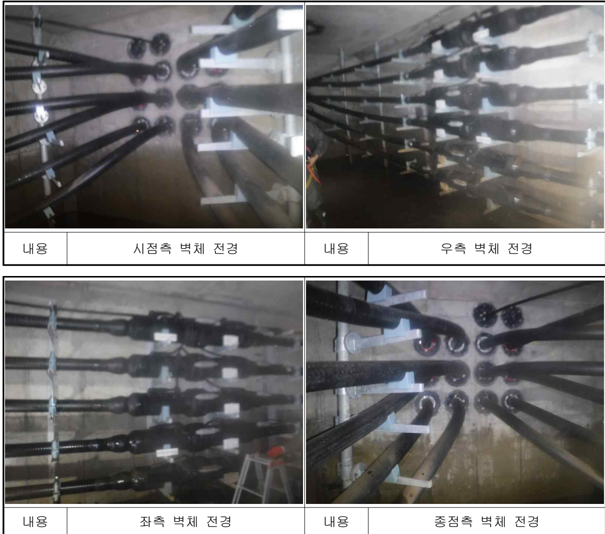
[사진 13.9] 신파주문발#7 전경
