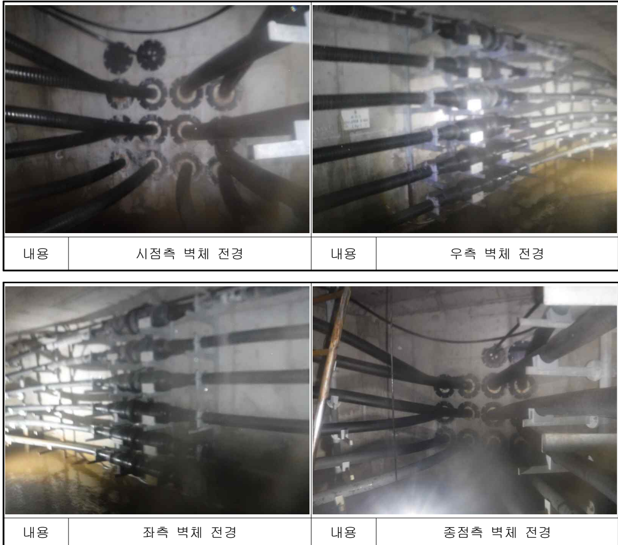
[사진 13.29] 신파주문발#12 전경
