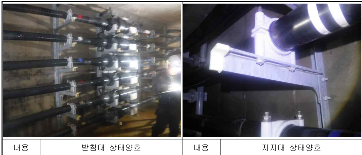
【사진 13.8】 부속 및 부대설비 현황
