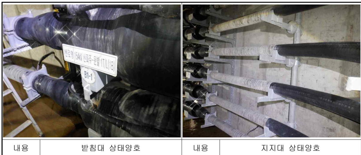
【사진 13.36】 부속 및 부대설비 현황
