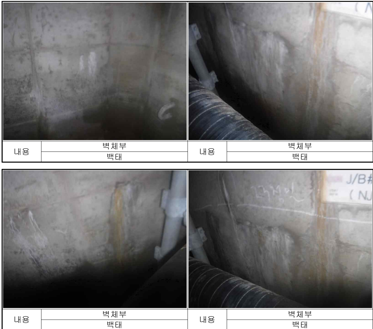
【사진 13.30】 맨홀 내부 주요 손상
