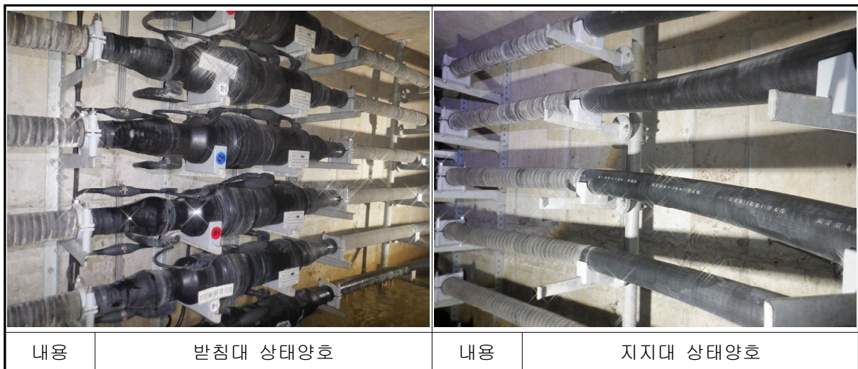
【사진 13.40】 부속 및 부대설비 현황
