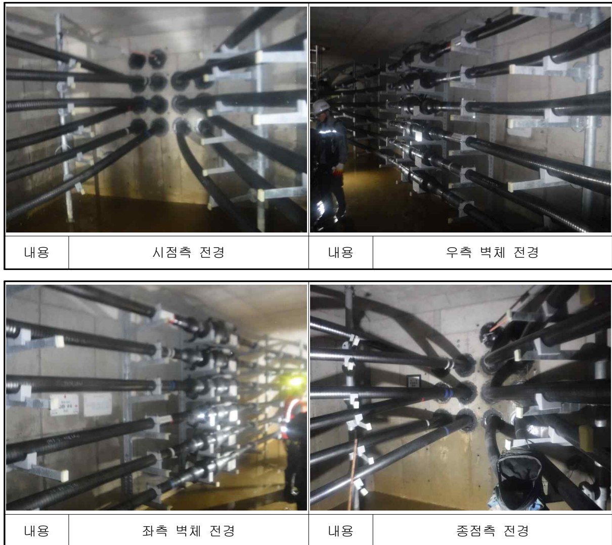
[사진 13.1] 신파주문발 #4 전경
