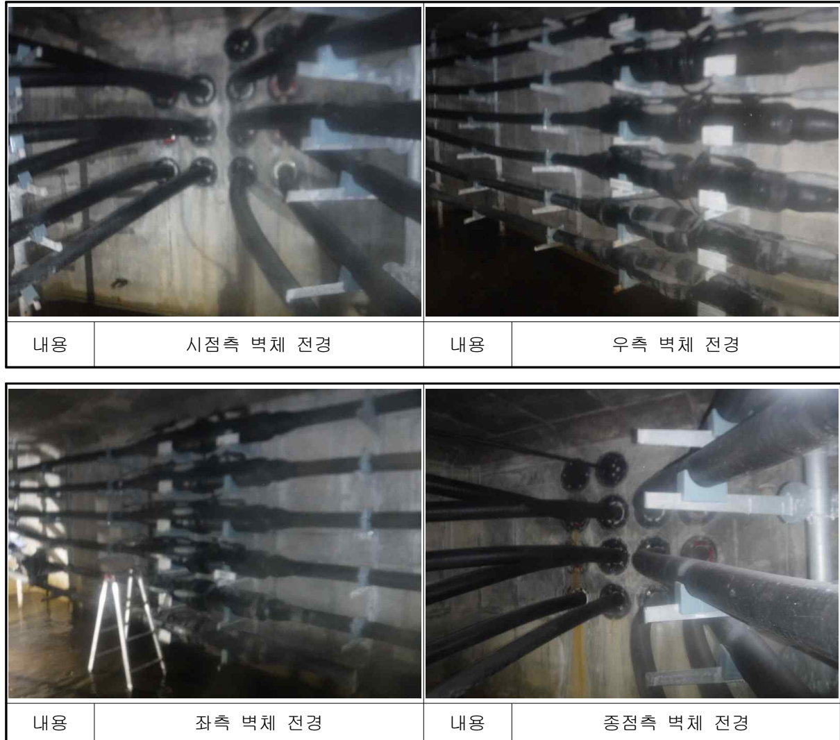
[사진 13.13] 신파주문발#8 전경
